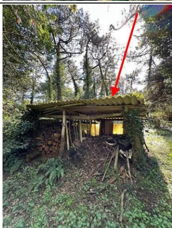
Photo n° PhA004 Localisation : Rez de chaussée - Appenti Ouvrage : 1 - Couvertures, Toitures, Terrasses et étanchéités - Plaques ondulées et planes Partie d'ouvrage : Plaques en fibres-ciment (y compris plaques « sous tuiles ») Description : Plaques en fibres-ciment (y compris plaques « sous tuiles »)
