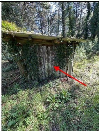
Photo n° PhA005 Localisation : Rez de chaussée - Appenti Ouvrage : 1 - Couvertures, Toitures, Terrasses et étanchéités - Plaques ondulées et planes Partie d'ouvrage : Plaques en fibres-ciment (y compris plaques « sous tuiles ») Description : Plaques en fibres-ciment (y compris plaques « sous tuiles ») en dépôt
